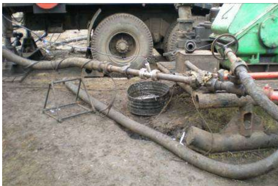
Рис. 38. Расходомер РСТ-16М в обвязке нагнетательной линии
