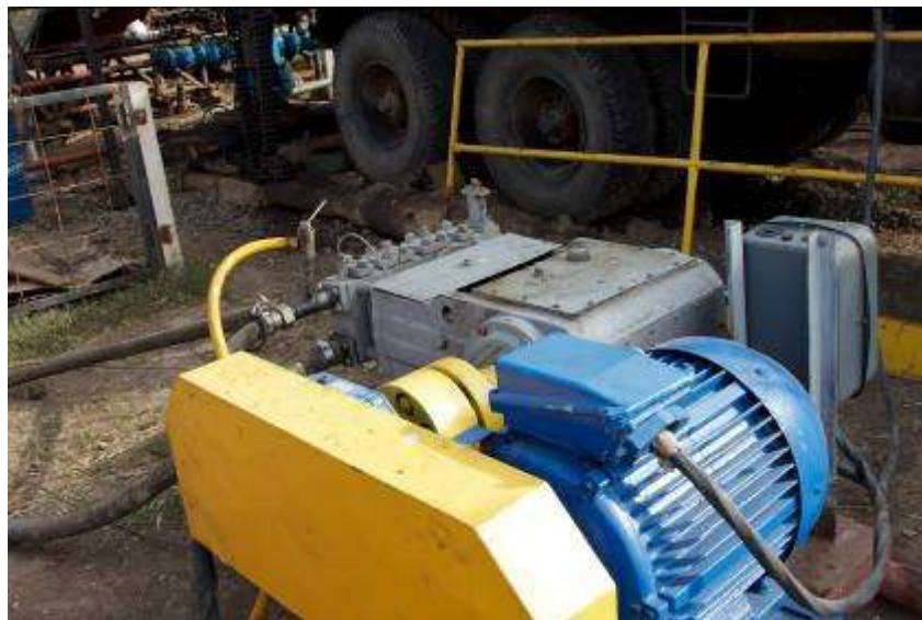
Рис. 44. Насосная станция с трехплунжерным насосом 1.3 ПТ-50Д2
